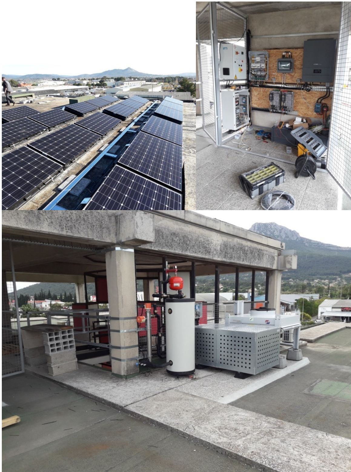
Figure 14 : Le pilote réalisé et opérationnel du projet PVcooling
