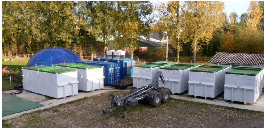
Figure 2.6 - Installation de méthanisation en voie sèche discontinue (procédé Eribox). Cinq containers sont utilisés comme enceintes closes où la matière est mise à fermenter (source : http://erigene.com/accueil ).
