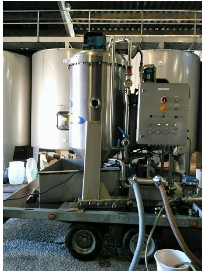
Figure 31 Filtre Béarnais Filtration
