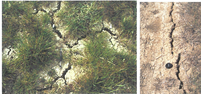
Figure 31 : fissure de retrait en mosaïque à gauche, fissure structurelle à droite (Lautrin, 2002)
