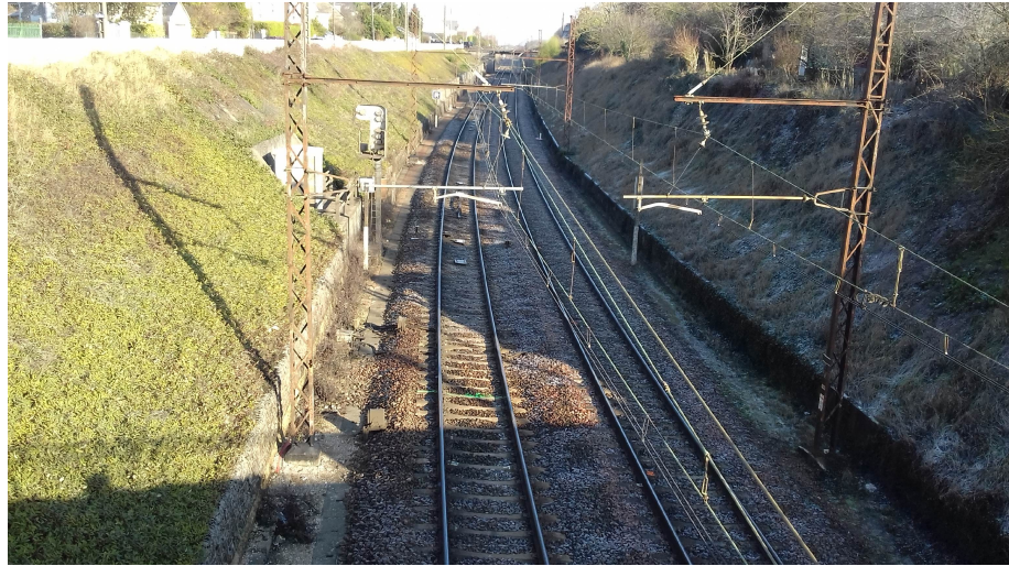
Figure 33 : Exemple de talus en déblai subissant des effets météorologiques différents selon leur orientation. Le talus orienté nord, à l'ombre, montre des traces de gelée blanche. Le talus orienté sud, nettement ensoleillé est totalement dégelé.
