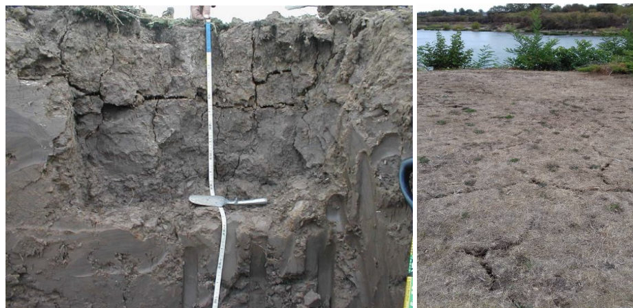
Figure 34 : (a) Fissures de retrait dans une digue à Thorngumbald – Royaume-Uni (approximativement 60 cm sous le terrain naturel) (Dyer et al., 2007). On distingue nettement les réseaux de fissures verticales et
