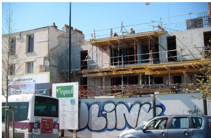
Figure 14 : Habitant 1, Photo 1 du tronçon 3 : immeuble en construction boulevard Jules Verne au niveau de l'arrêt de bus Chocolaterie :
