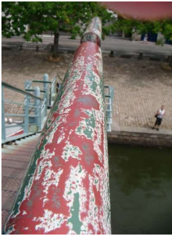
Hbt 43, Photo 5 du tronçon 1 : rambarde usée de la passerelle de l'Île Versailles
