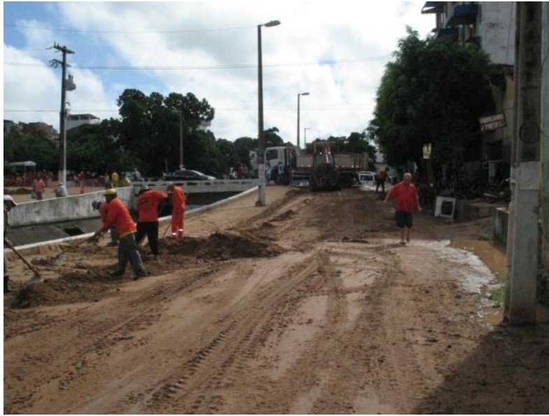
Figure 2.19. Réparation de dégâts causés par le débordement du canal du Rio Grangeiro en avril 2015. (Source : Journal Diário do Nordeste, 23.04.2015). http://diariodonordeste.verdesmares.com.br/cadernos/regional/online/chuva-forte-causa-transtornos-no-crato-e-em-outras-cidades-do-cariri-1.1274889
