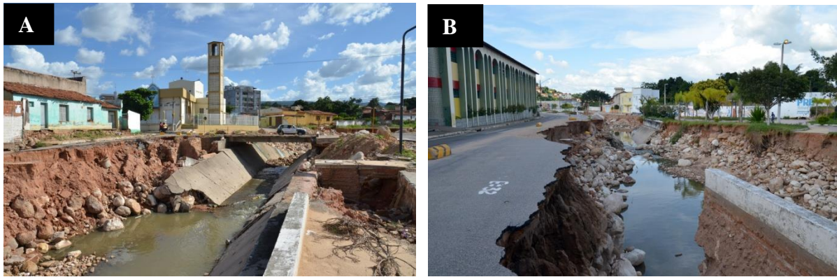
Figure 5.17. Vulnérabilité des abords du canal du Rio Granjeiro dans les quartiers Pimenta et Seminário : destructions consécutives à la crue du 28 janvier 2011. A. Abords de l'église Nossa Senhora da Fátima (Pimenta). B. Abords du collège Objetivo (Seminário). Photos : A.O. Magalhães, 2011.
