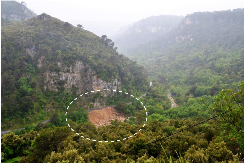
Figure 7.12. Destruction partielle de la route D 955 dans la gorge de Châteaudouble à la suite de la crue de la Nartuby du 15 juin 2010. Photo : A.O. Magalhães, 2012.
