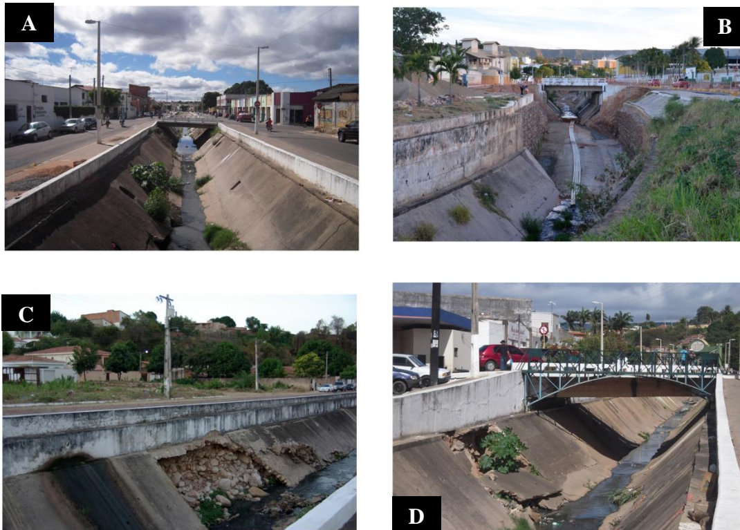
Figure 2.7. Le « canal » du Rio Granjeiro : géométrie et défauts d'entretien. Photos : JP. Peulvast/A.O. Magalhães.
