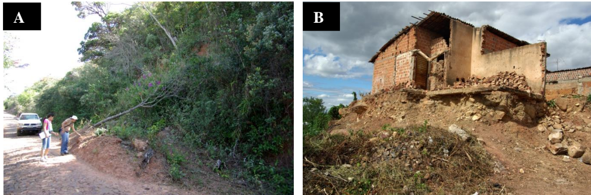
Figure 5.8. Mouvements de terrain effectifs ou possibles en zones artificialisées. A. Petit glissement rotationnel ( slump ) survenu en fin de saison des pluies à Farias (Barbalha) sur la route de la Chapada taillée dans des grès Exu altérés. B. Maison en péril sur un rebord de haute terrasse du Rio Granjeiro, quartier Caixa d'Água, Crato. Bâtie sur un substrat riche en blocs, déstabilisé par des terrassements (tranchée routière), la maison a été ultérieurement démolie et remplacée par un petit immeuble. Photos: J.P. Peulvast/ A.O. Magalhães, 2008 et 2014.
