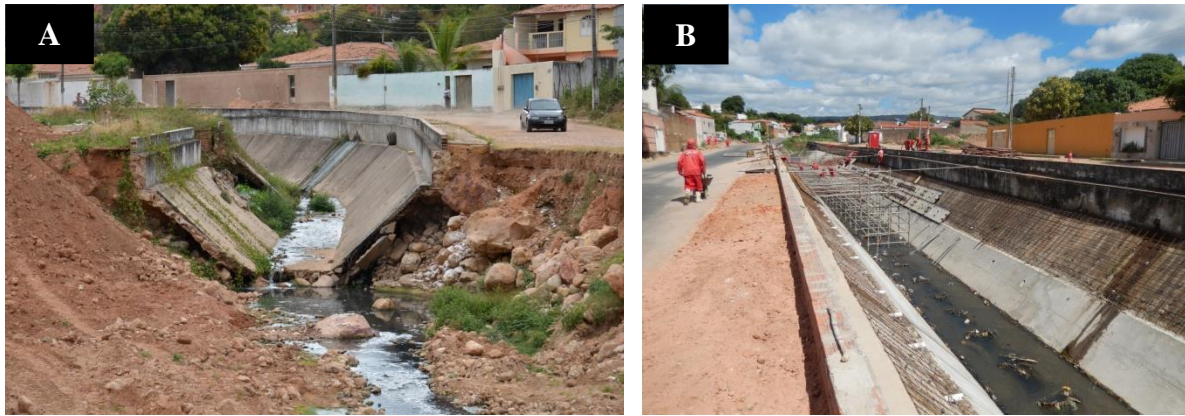
Figure 5.30. Le canal du Rio Granjeiro et sa reconstruction après la crue de janvier 2011. A. Destruction partielle après la crue éclair, montrant l'insertion sans fondations dans du matériel de terrasse non consolidé, ainsi que la minceur des plaques de béton. B. Reconstruction en juin 2013, avec pose de matériel compacté entre la paroi en béton et le substrat de l'avenue latérale. Quartier Pimenta. Photos : A.O. Magalhães.
