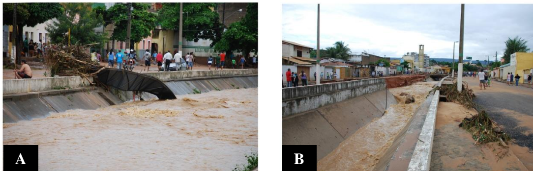
Figure 2.10. Écoulements de fin de crue et embâcles dans le Rio Granjeiro. Photos : H. Maia et W. Vieira, 2011. A : Passerelle détruite et partiellement emportée, centre-ville (28/01/2011). Photo H. Maia et W. Vieira. B : Écoulement turbulent et embâcle de blocs de béton, aval de l'église Nossa Senhora de Fátima (28/01/2011). Photos H. Maia et W. Vieira.
