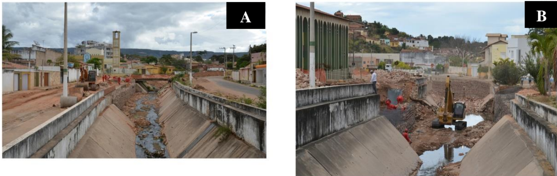
Figure 4.8. Réparations du canal du Rio Granjeiro après la crue du 28 janvier 2011. A : À l'aval de l'église Nossa Senhora de Fátima ; B : Devant le collège Objetivo. Pose de gabions à même le lit du cours d'eau dans les tronçons détruits par la crue de janvier 2011. Maintien de la section trapézoïdale ailleurs, ainsi que des ponts trop bas, induisant des variations de forme transversale et de calibre propices à une accentuation des turbulences et de la puissance érosive de l'écoulement de crue. Photos : A.O. Magalhães, 2011.
