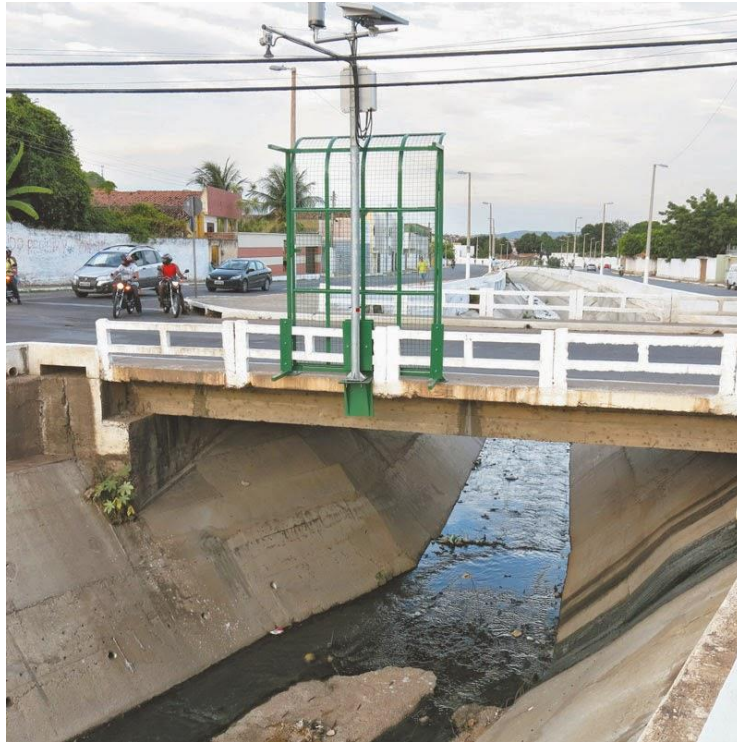
Figure 6.31 : Plateforme de collecte de données hydrologiques (pluviométrie, hauteur d'eau, débit) installée en 2014 sur le Canal do Rio Granjeiro, Crato. (Source : https://www.blogcariri.com.br/2014/12/crato-ce-plataformas-de-dados.htm ).
