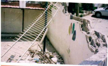
Jénine : destruction aire de sport
