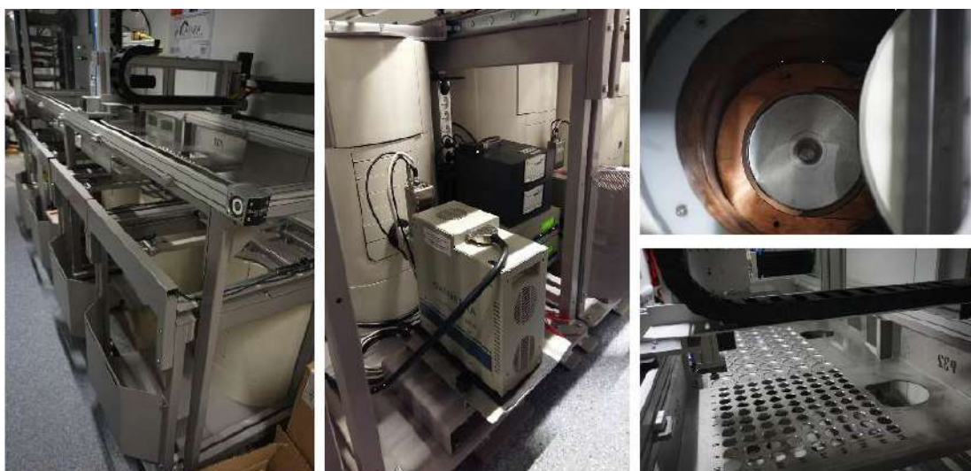
FIGURE 4.12 – Spectromètres bas bruit en fonctionnement au LAFARA. Le passeur innovant est visible sur la photo de gauche. Les cinq spectromètres sont refroidis par cryogénérateur électrique CP5+.
