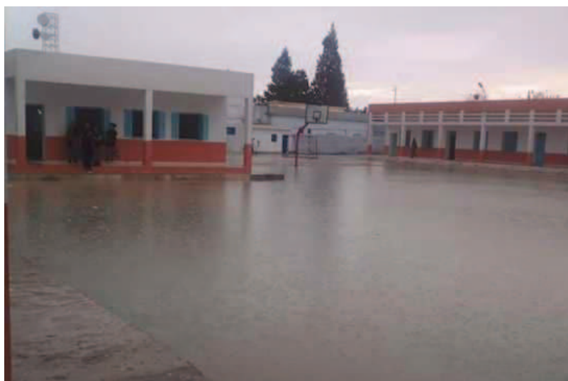
Photo.6.9 : L'évènement pluvieux du 05 octobre 2017 (Lycée Chedli Atallah- Rue de Fès- Ville de Kairouan)
