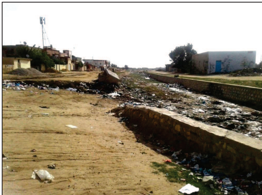
Photo 4.2 : Canal Fellet Galla (Cité Ouled Chelbi dans la ville de Sidi Bouzid). Accumulation de déchets plastiques dans le canal pouvant causer des phénomènes d'embâcle lors des inondations. Cliché NASRALLAH Wafa (20 Avril 2018).
