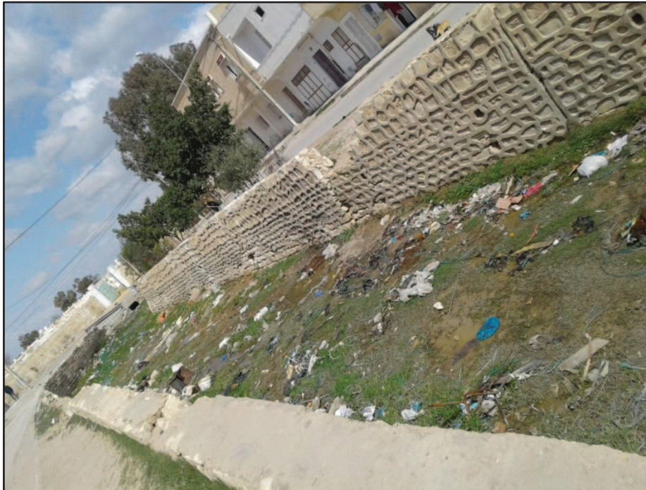
Photo 4.3 : Un cours d'eau canalisé à quartier El Mansourah à la ville de Kairouan. Cliché NASRALLAH Wafa (le 27 Mars 2018)
