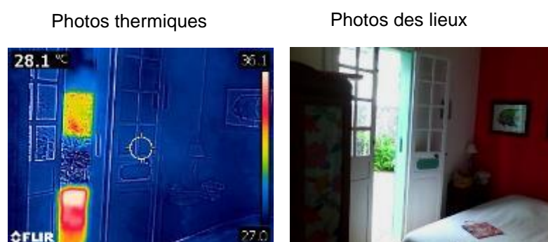
Figure 2- 26: Images thermiques chambre Est (à gauche) - photo des lieux (à droite)
