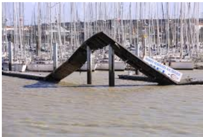
Figure .1.1: Tempête Xynthia à La Rochelle - Dégâts au Port de Plaisance des Minimes (source : wikimedia.org)
