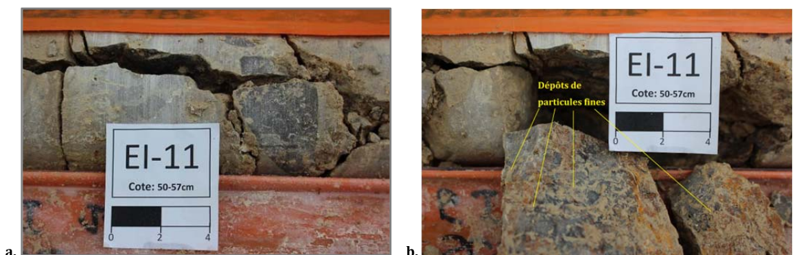
Figure 11- 21 a) zoom d'une zone de macro-fracturation à 11,5 m de profondeur (SC2), b) dépôts de fines et traces d'oxydation le long d'une fracture à 11,5 m de profondeur (SC2).
