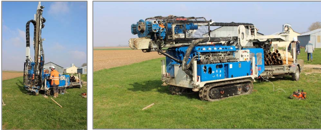
Figure 10- 2 Machine foreuse pour la réalisation des puits sur le site d'étude à Villamblain.
