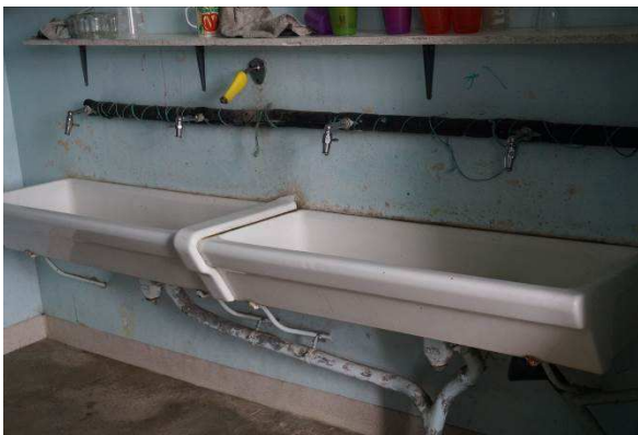
Photographie 94 : les lavabos des toilettes par Ludovic, CM1
