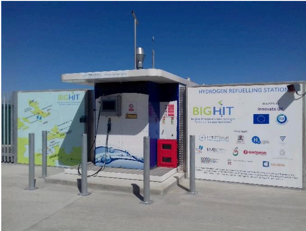
Figure 39. Une station de ravitaillement en hydrogène dans la ville de Kirkwall dans les Orcades. Cliché de l'auteur, 2018.
