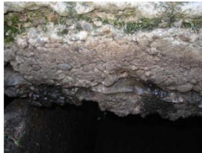
Figure I.26 – Biodétérioration de la dalle d'une fosse à lisier [BERT04]
