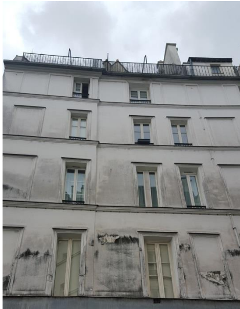
Figure 0.3 – Exemple de développement biologique en façade, avec décollement du revêtement
