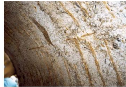
Figure I.27 – Biodétérioration d'un collecteur [COEC07]
