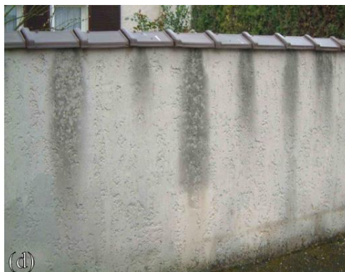
Figure I.32 – Salissures sous des joints de carreaux [BARB06b]
