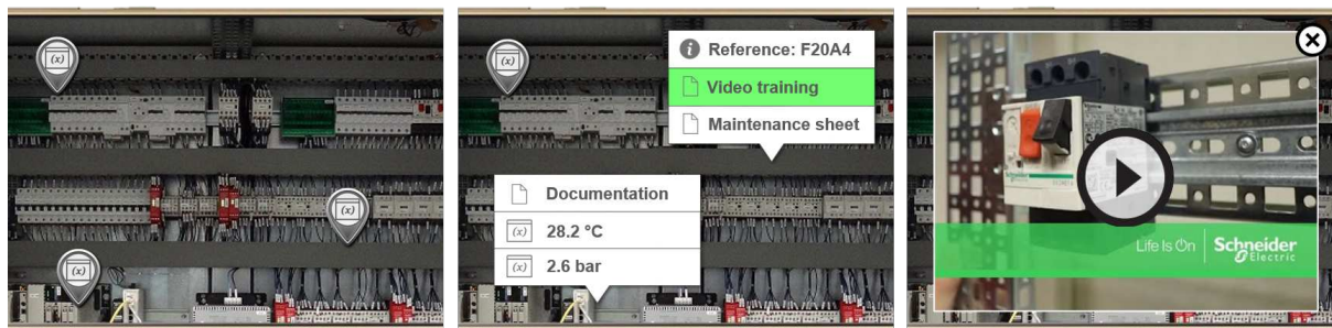
FIGURE 2.1 – Accès aux données d'aide à la maintenance d'une armoire électrique, regroupées sous forme de POIs (a) 3 POIs fermés placés sur une armoire électrique. (b) 2 des 3 POIs ouverts, affichant des informations sur la température et la pression de la machine, ainsi que la possibilité d'accéder à deux documentations techniques et à une vidéo explicative. (c) Lancement de la vidéo explicative sur le montage et le démontage d'un composant de la machine (image issue de [80]).
