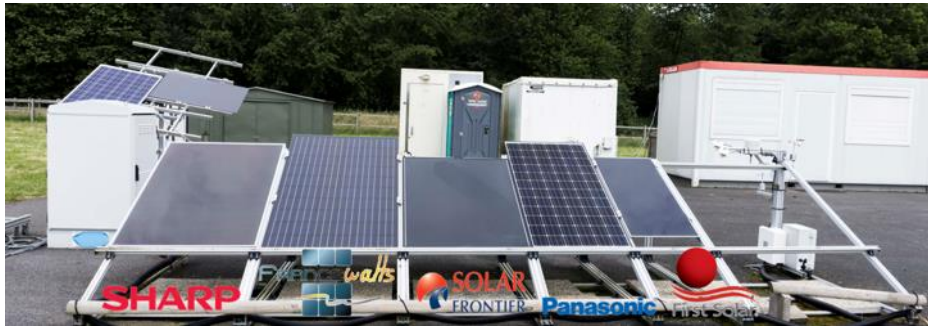
Figure 55 Banc de caractérisation photovoltaïque du SIRTA
