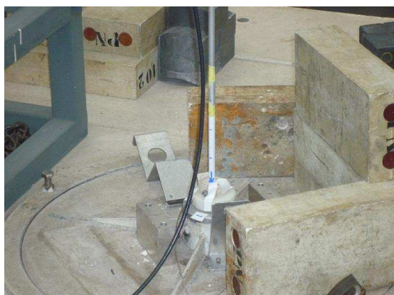
Figure 5.4 - Photographie du toit du réacteur BR1, au niveau du point d'insertion des cannes de mesure dans la cavité
