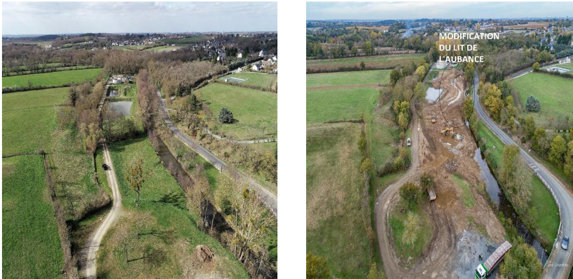
Figure 136. Photographies aériennes obliques (prises par drone) du secteur de l'Aubance en cours de restauration ; g. Avril 2018 ; d. Novembre 2018 (Saint-Mélaine-sur-Aubance, Source : Syndicat Layon Aubance Louets 169 )
