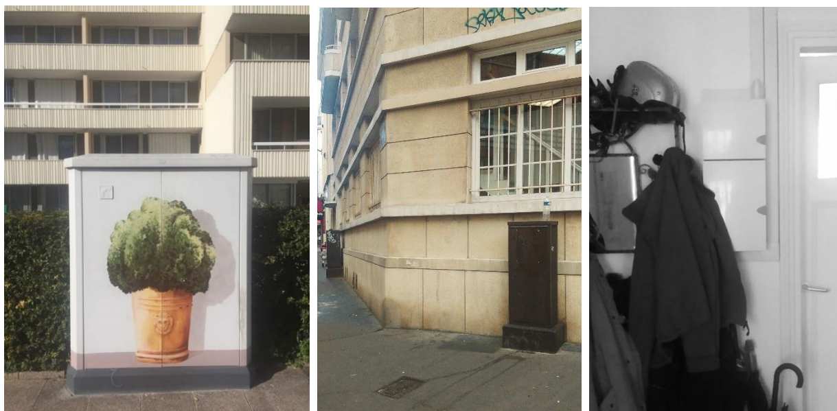
Figures 1.2, 1.3 et 1.4 : éléments techniques électriques dans l'urbain (crédit photo : Flora Aubert)
