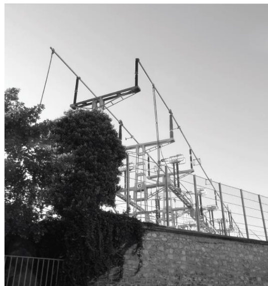
Figure 1.7 et Figure 1.8 : Poste de transformation électrique à Charenton (crédit photo : Joris Thau et Stanislas Jung)
