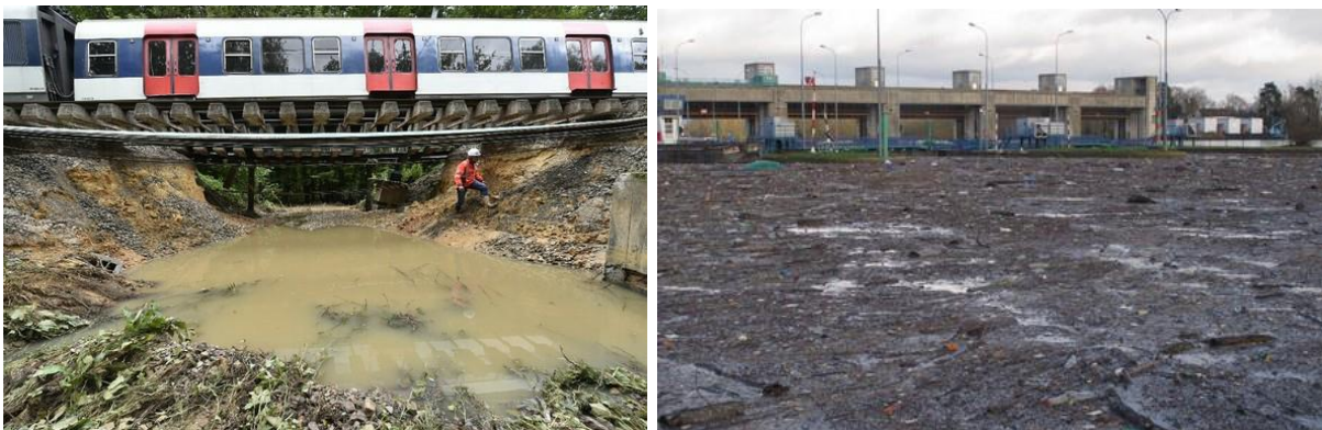
Figure 142 : L'effondrement du talus du RER C et les déchets bloqués au niveau du barrage de Méricourt. Source : (DDT Yvelines).
