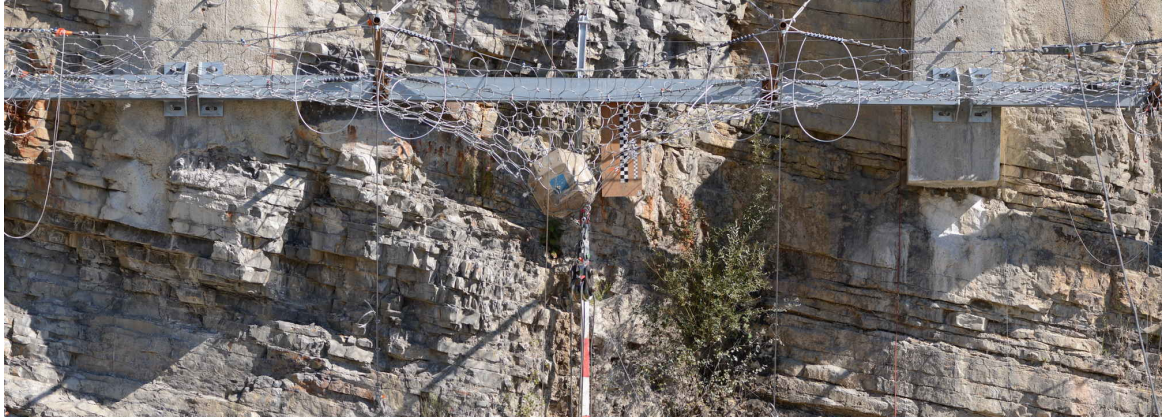
FIGURE 2.18 – Equilibre sous poids propre de l'écran et du bloc avant application de l'effort du treuil (source : C2ROP)
