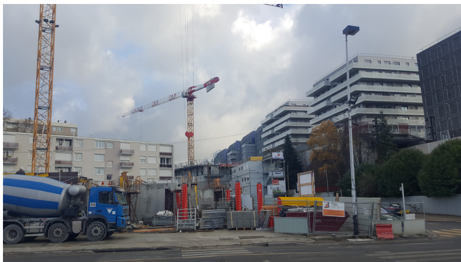
Terrasses de La Défense, cité des Provinces Françaises à gauche, travaux du Cœur de Quartier Phase II – © Auteure, novembre 2017
