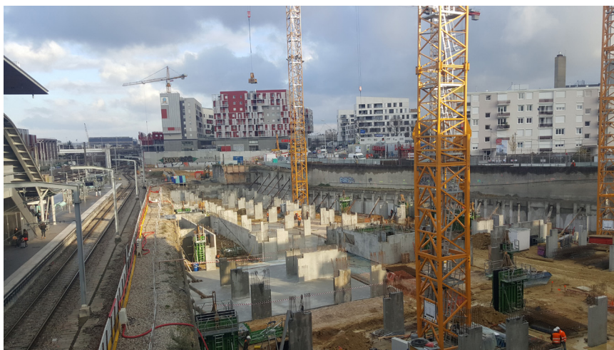
Chantier de l'Opération Cœur de Quartier, depuis la gare de Nanterre Université, photo prise en novembre 2017 par l'auteure
