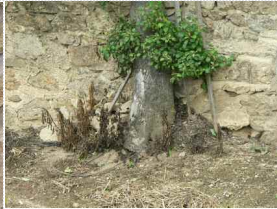
Désherbage chimique au pied de la poirière : il laisse une terre à nue qui favorise le ruissellement rapide des eaux de pluie, facilite l'érosion et ici, le déchaussement du mur.
