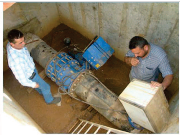
Une valve de réduction de débit du réseau de Kamed El Loz
