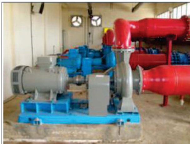
La station de pompage de Joub Jannine
