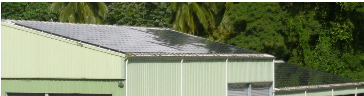
Photo 21 : Photovoltaïque sur toiture dans la commune de Saint-Pierre. Auteur : François Ory, 2017.
