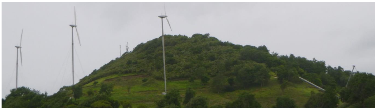
Photo 12 : Les quatre éoliennes du Vauclin. Elles sont couchables, comme celle de droite, afin de les protéger des cyclones ou pour faciliter les opérations de maintenance.
