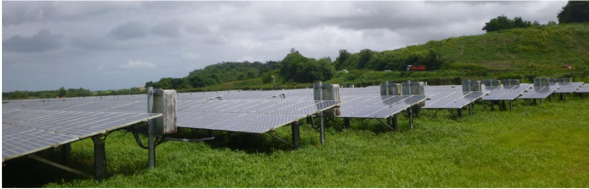
Photo 22 : Photovoltaïque au sol dans la commune de Ducos. Auteur : François Ory, 2018.
