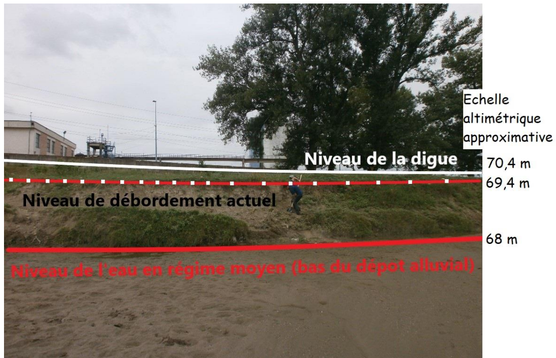
Figure VII.8. Le débit à plein bord probable sur le tronçon de la rivière Jiu entre la s.h. Podari et la tranchée (cliché : Moroşanu, 2017)
