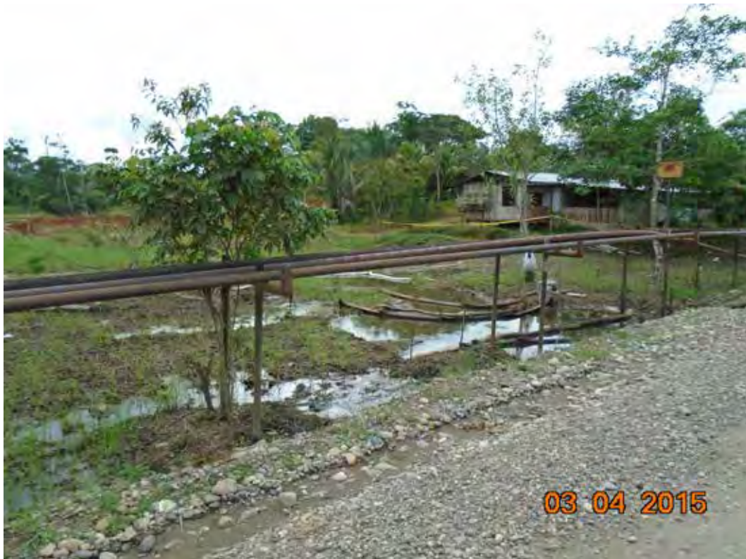
Image 10 Fuite en cours de remédiation (Juan Montalvo, Pacayacu, 2015)
