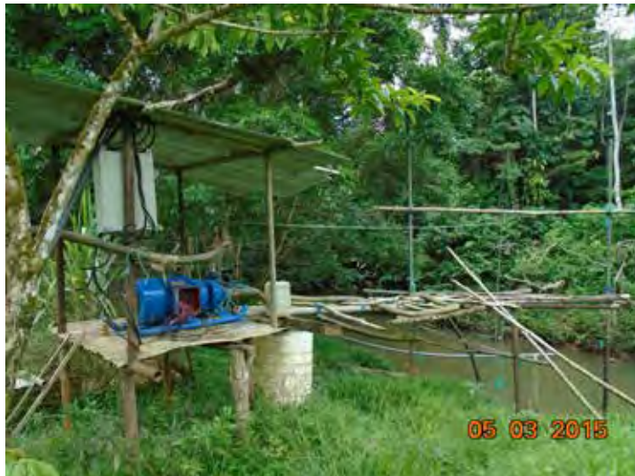
Image 24 : Captage pour l'usine d'eau potable de Dayuma pour compenser le faible débit du forage, 2015
