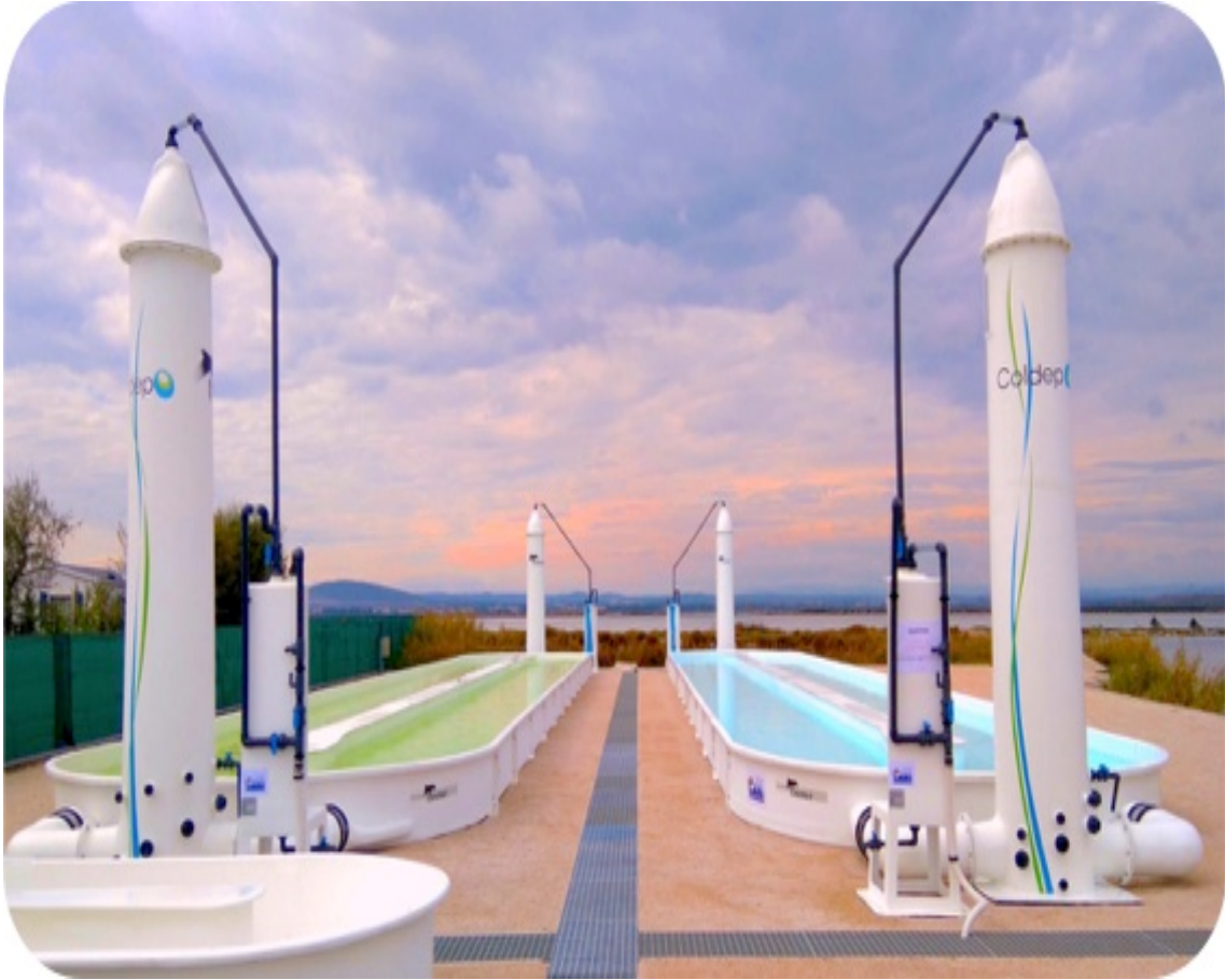
FIGURE 1 – Installation de colonnes à bulles sous dépression à Palavas-Les-Flots
