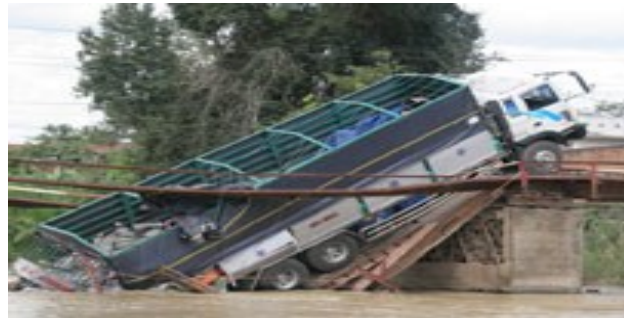
Figure 3.15 : Des défaillances causées par la corrosion, la collision/surcharges
