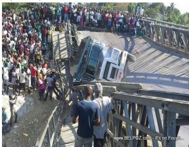
Défaillance ,pont Duviver (Haïti)
