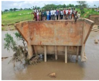
Défaillance, pont Shendam (Nigeria)
