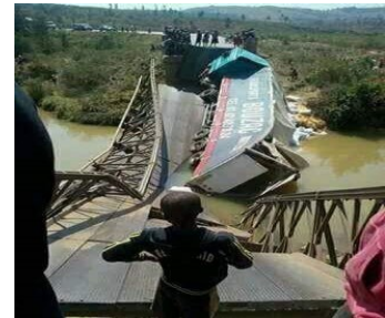
Défaillance, pont RN7(Madagascar)
