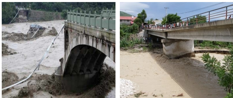
Figure 3.14 : des défaillances causées par l'affouillement et détériorations
