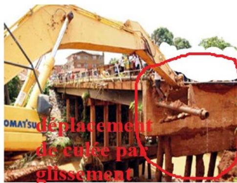
Figure 4.28 : Défaillance du pont Abakpa
