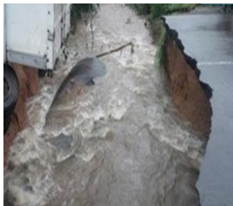
Défaillance, pont Matomb (Cameroun)
