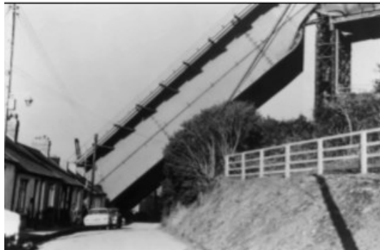
Figure 3.8 : Extrait de défaillance d'un pont à poutres-caissons [BRI 09]
