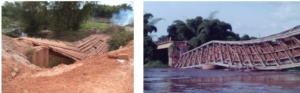
(a) détérioration pont RN1 (2013) (b) ruine du pont Mouyondzi (12/04/2012)
