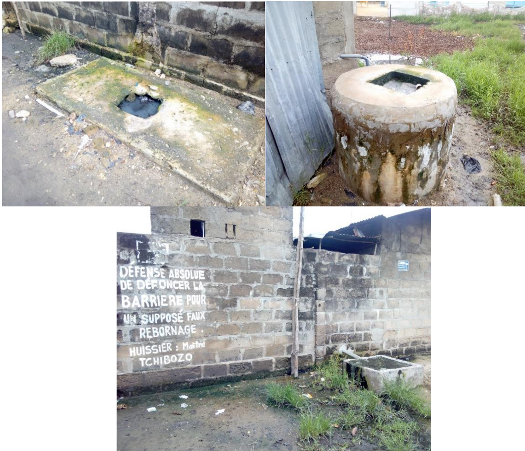
Système d'évacuation des eaux usées provenant des douches à Ladji (Source : Travaux de terrain, 2017)
