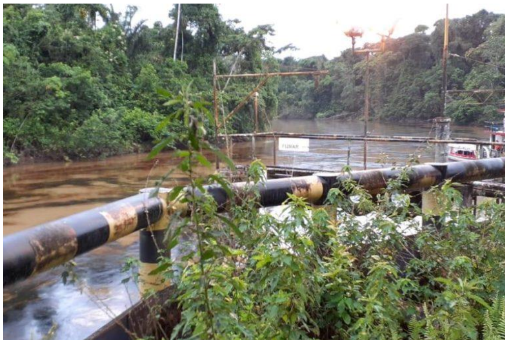
Figure 41. Fuite de pétrole le 23 novembre 2019 dans le sous bassin du Marañon (rivière Corrientes).
