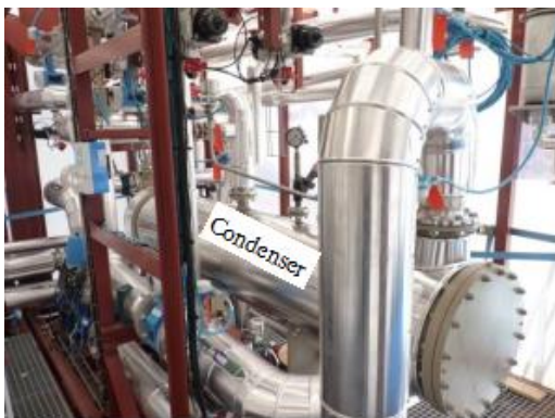
Figure 73. Photographie du condenseur COND1 du PAT ETM (©Naval Energies)
