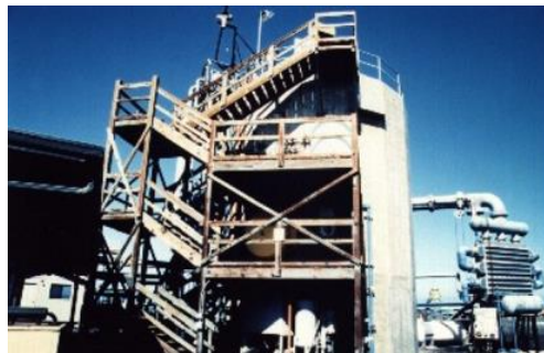
Figure 36. Installation de 210 kW brut ayant fonctionné à Hawaï de 1993 à 1998 (©NEHLA, L. Vega, référence [22])
