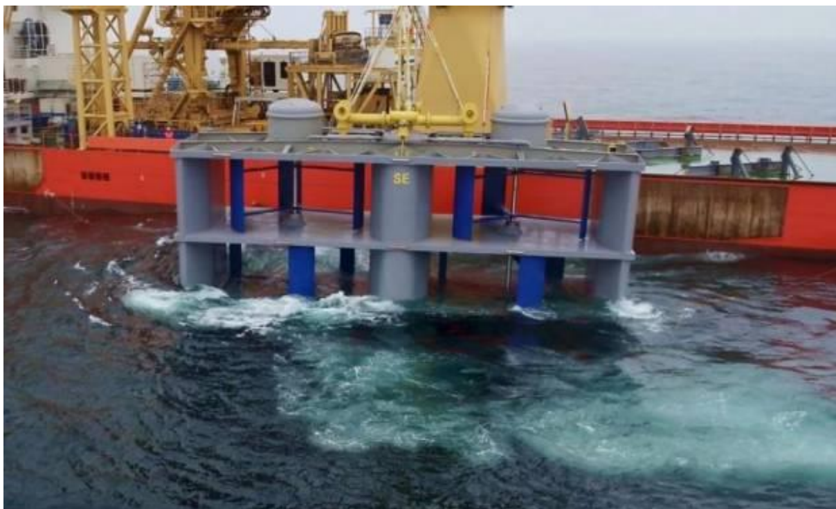
Figure 1.38. Image prise lors de l'installation de l'hydrolienne OCEANQUEST sur le site d'essai de Paimpol Bréhat [64].
