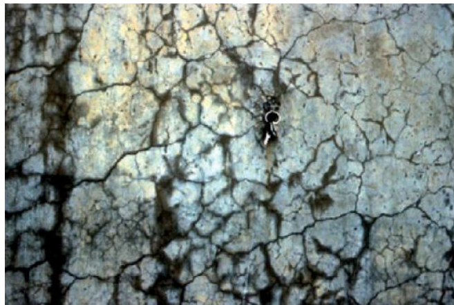
Figure I-23 : Réseau de fissures d'un mur en aile affecté par la RAS (Godart et al.2008)
