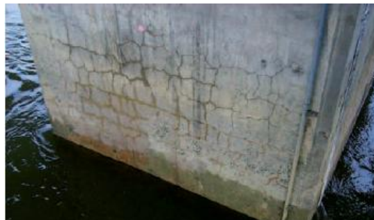
Figure I-1 : Réseau de fissure d'une pile de pont affectée par la RSI (Godart et al.2009)
