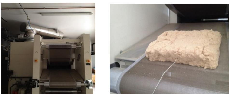
Figure 65 : Vue d'entrée du four Strahm et dépôt d'un matelas à son entrée avant sa consolidation thermique
