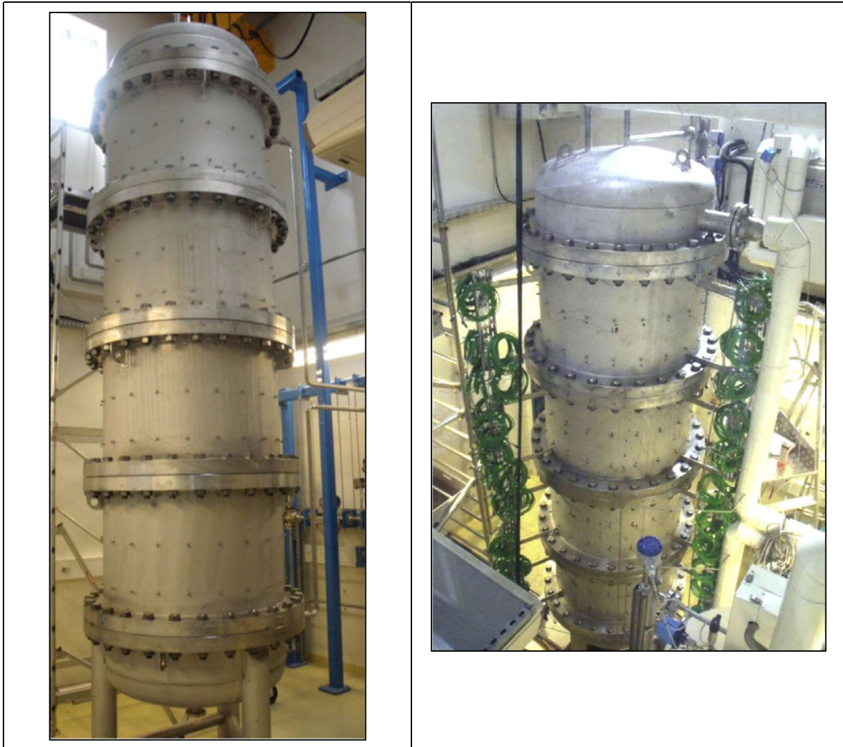
Figure 14 : photographies de la cuve de STONE sans calorifuge.
