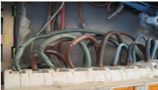
(a) Exemple de fissures dans les câbles
