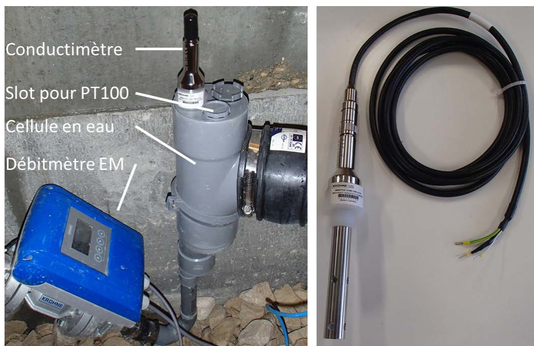
Figure 2.17 : Photo de l'emplacement de la sonde et de la sonde elle-même de conductivité (Smartpat de la marque Krohne)
