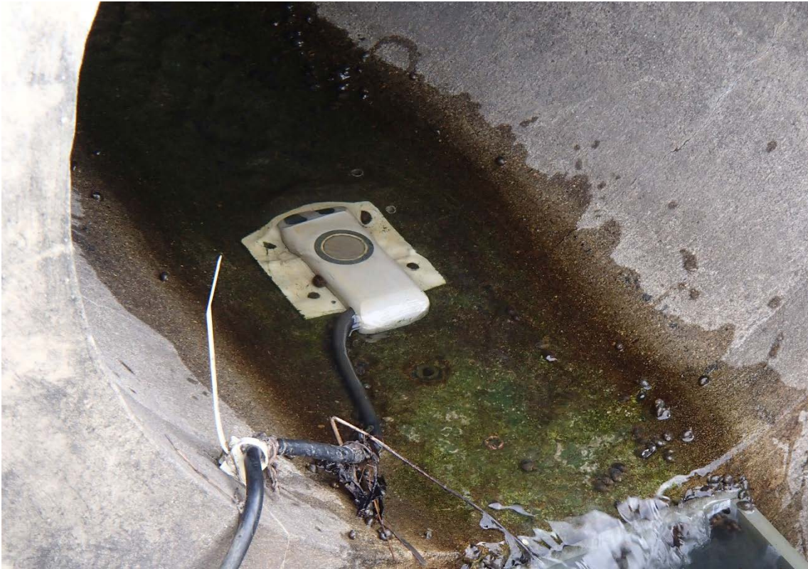
Figure 2.20 : Capteur Flopro Série 3 [MACE] assurant la mesure de débit dans la conduite d'évacuation des eaux du bassin de rétention Django Reinhardt (sortie)
