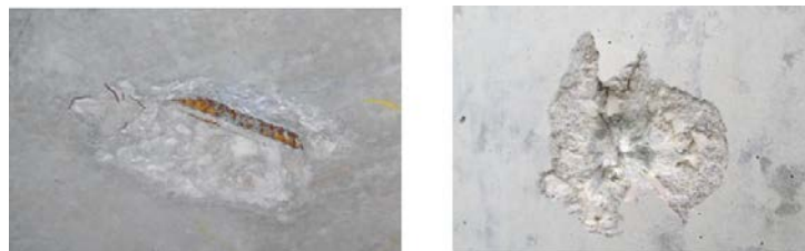
FIGURE 5.1 – (Gauche) Défaut avec fer apparent (Droite) Défaut sans fer apparent.
