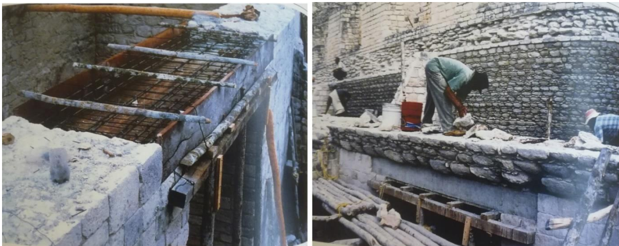
Fig. IV-8. Linteaux de soutènement incorporés aux accès des chambres inférieures de la structure I-A (Campaña Valenzuela et al. , 2004).
