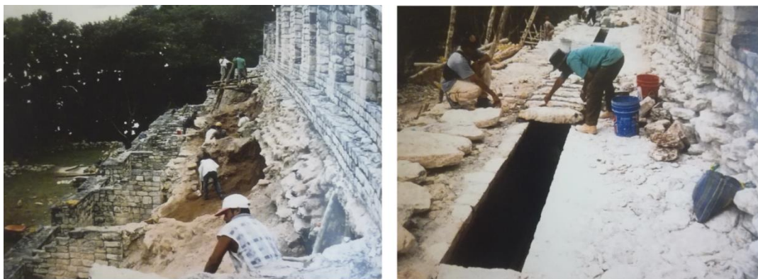
Fig. IV-6. Construction en cours (à gauche) et finalisée (à droite) de la terrasse d'accès au niveau supérieur de la structure I (Campaña Valenzuela et al. , 2004).
