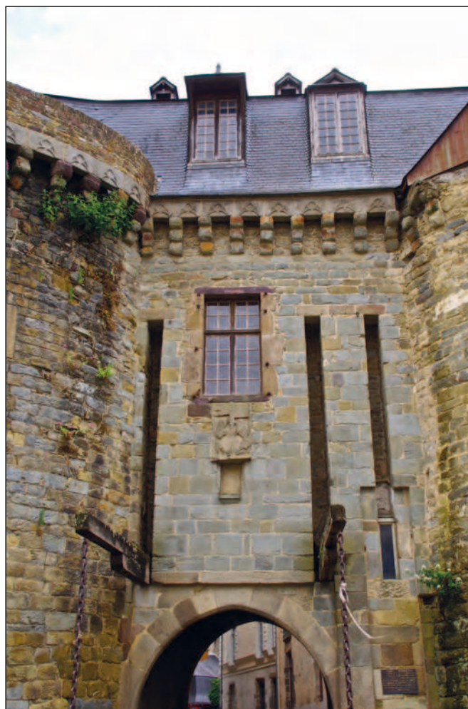
Fig. 157 : Corbeaux en schiste à trois ressauts sur le châtelet d'entrée des portes Mordelaises
