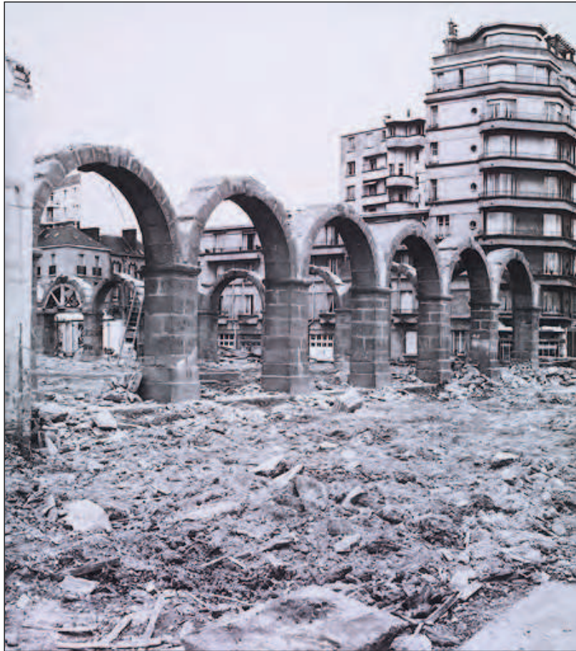
Fig.24 : Destruction des arcades du cloître du couvent du Colombier, photographie de C. Barmay, 1966, MB, 2002.0047.1995
