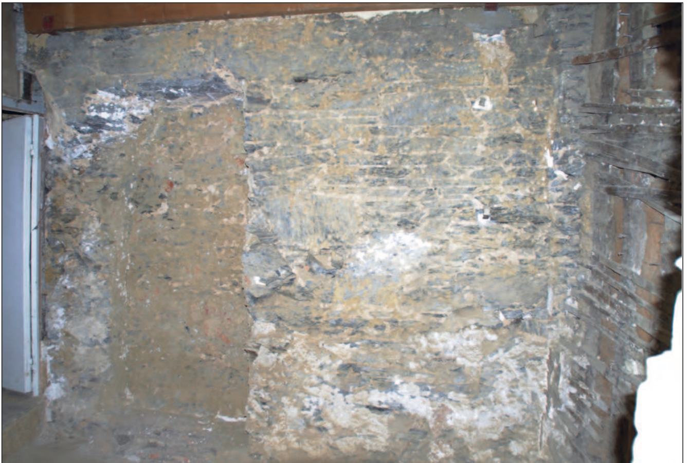
Fig. 187 : Boulevard de la porte aux Foulons dans au RDC du n°6, le parement externe est constitué d'un appareillage assez hétérogène de moellons de schiste bleu liés au mortier de chaux gras
