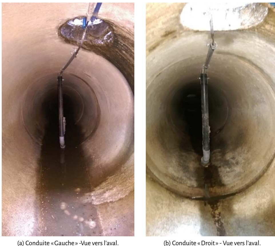
Figure 7.3 – État des conduites de déversement «Gauche» (Fig. 7.3a) et «Droit» (Fig. 7.3b) en temps sec.
