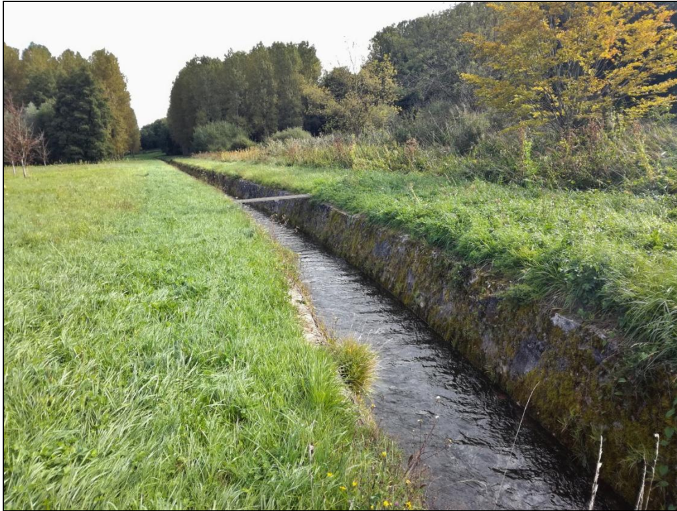
Figure 6.8 - Lit bétonné de la Traconne (autre nom de la Voulzie) dans le périmètre des captages de la Voulzie. Ces travaux anciens ont pour but d'éviter les infiltrations d'eau dans la nappe. Photo : M. Resch, 16 septembre 2017.
