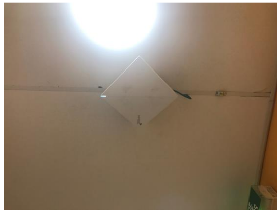
Fig. 4.19. Routeur Wi-Fi modèle AP 120 de Aerohive installé au plafond du couloir.
